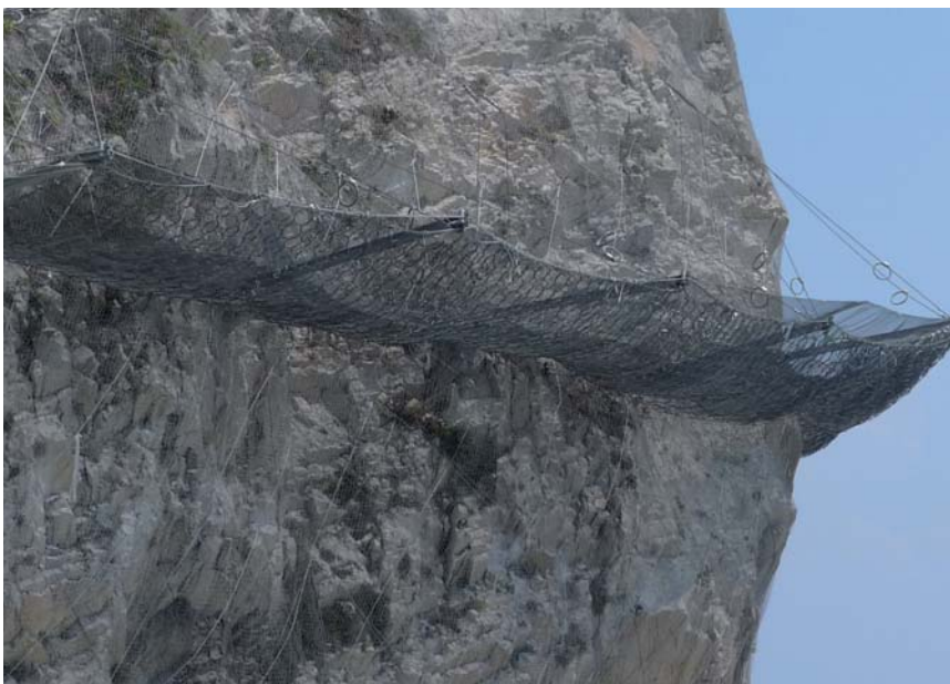
Una sottile rete sintetica sul lato di monte della barriera impedisce la caduta in strada anche di frammenti minuti di roccia
