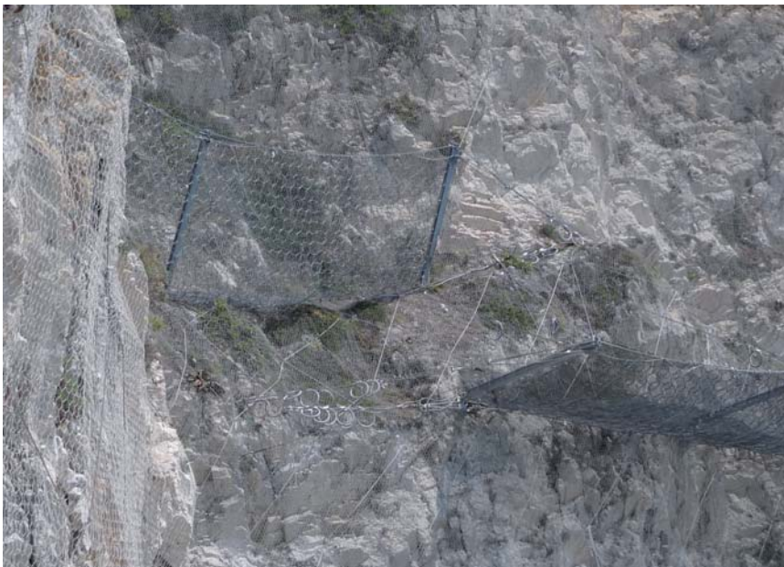
Vista ravvicinata delle barriere installate
